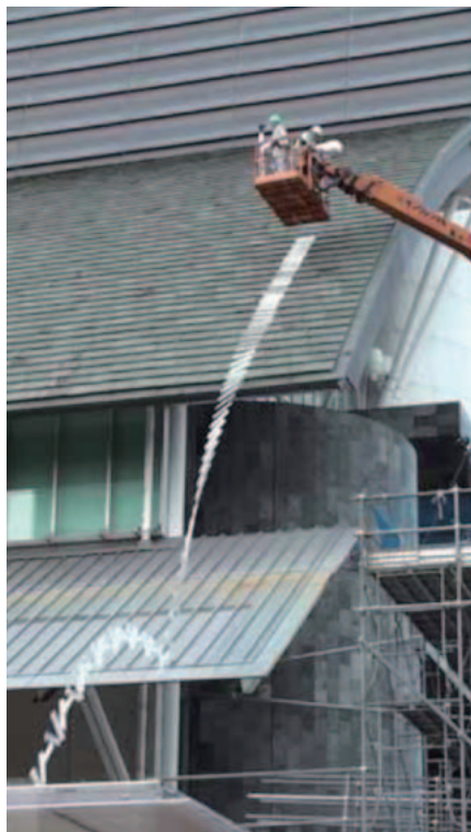
スレート片の落下実験
