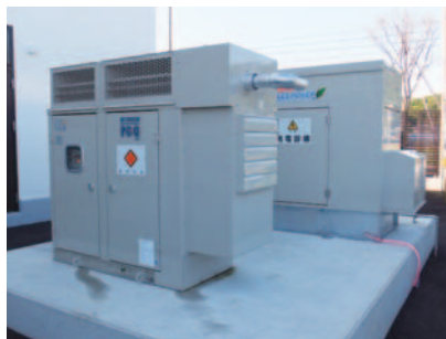
3日間稼働する自家発電装置
