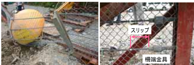
写真1 柵の変形 写真2 緩衝金具とスリップしたワイヤロープ
