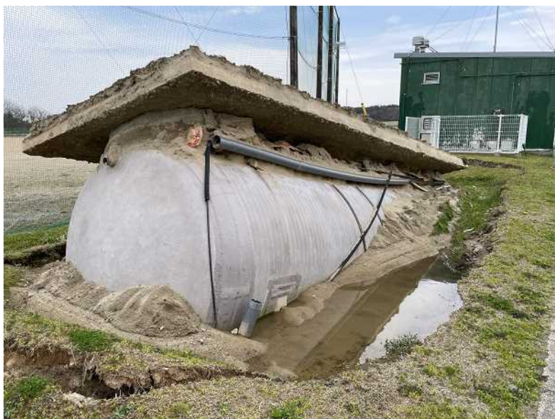
液状化で飛び出した「のと里山空港」の燃料タンク
